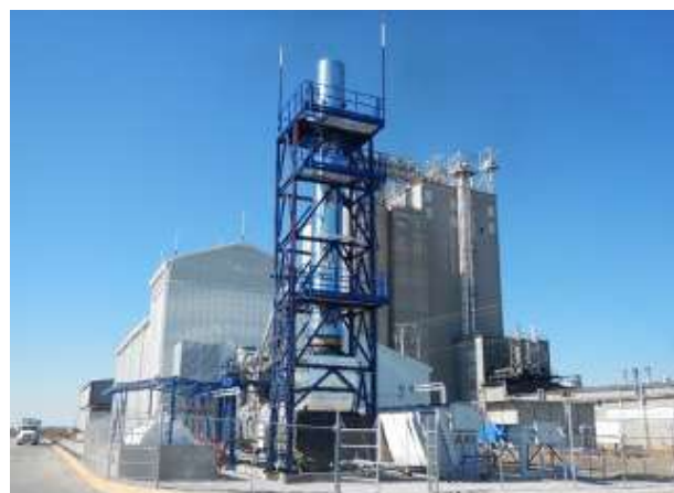
Planta de Cogeneración
